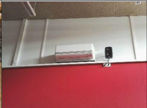
Uusitun musiikkiluokan ilmalämpöpumpun sisäyksikkö.
