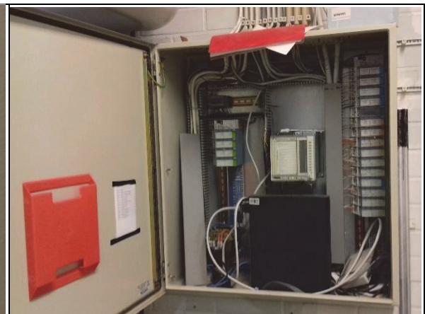
AK1- alakeskus lämmönjakohuoneessa.
