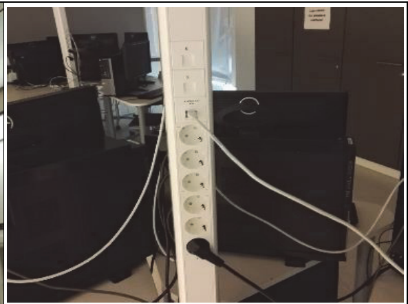
Uusitun luokkahuoneen pylväspistorasia
