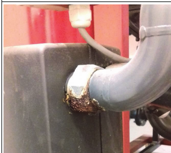
Vuotava lämmönsiirtimen liitos
