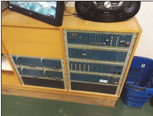
Alkuperäinen keskusradion ohjausyksikkö
