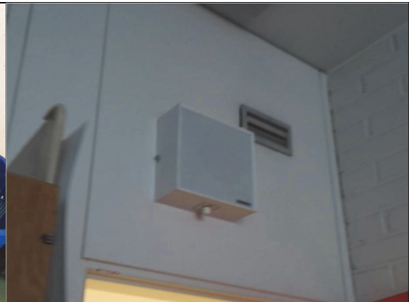
Keskusradion uusittu kaiutin luokkahuoneessa.
