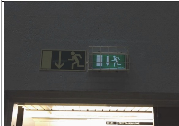
Uusittu opastevalaisin liikuntasalissa.
