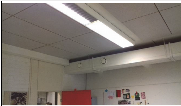
B-rakennuksen tulostushuoneen katossa kulkeva suorakaidekanava
