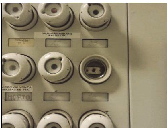
B7-keskuksen puuttuva kosketussuojaus
