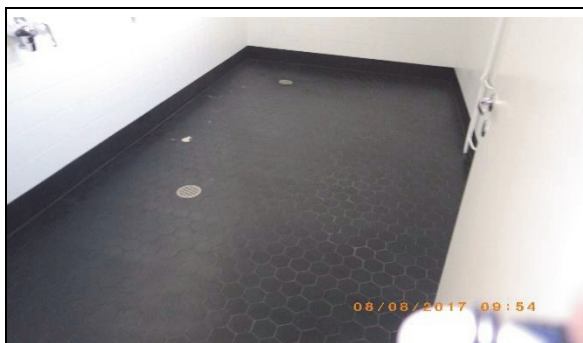
Liikuntasalin oppilassuihkutilojen vanhat kaakeli-pinnat on maalattu, pinnoite osin irronnut latti-asta
