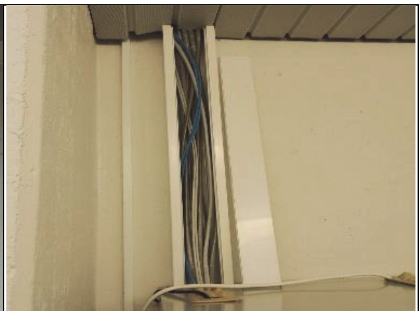
Johtokanavan peitelista irroitettu.
