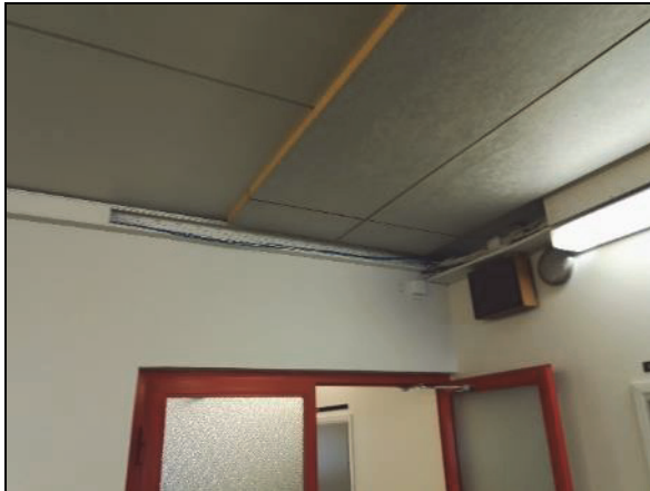
Puuttuvia johtokanavien peitelistoja
