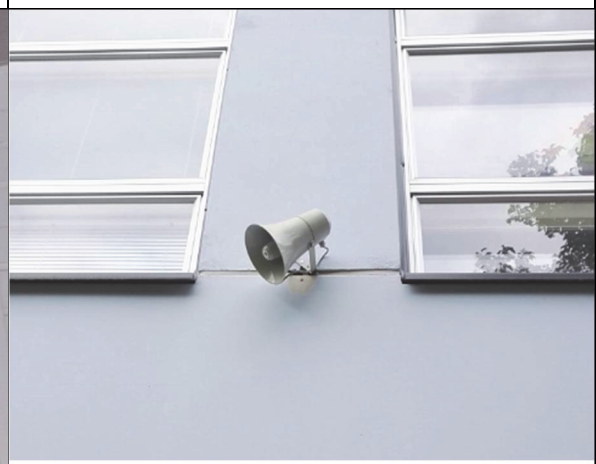
Julkisivuun asennettu torvikaiutin.
