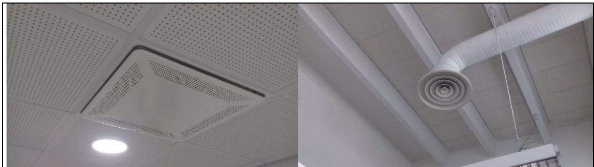
B-rakennuksen käytävän uusi tuloilmahajottaja
