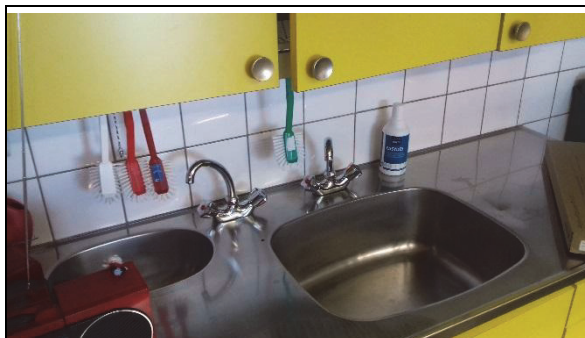
B-rakennuksen terveydenhuollon tiloissa sijaitsevat vanhat kaksiotehanat
